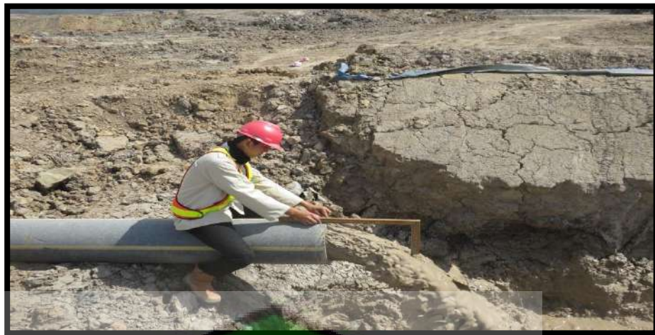
Gambar 4.2 Pengukuran Debit Aktual Pompa
